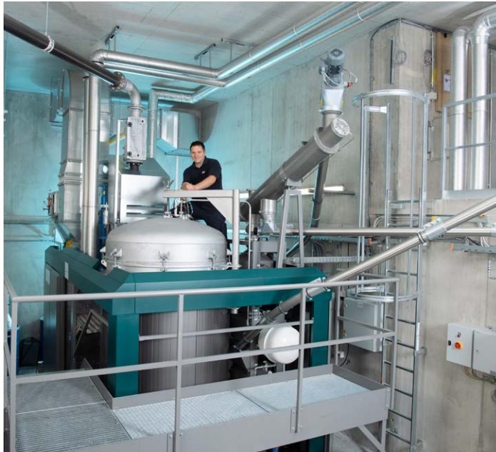
Anfang 2018 nahm die AEW den schweizweit einzigartigen Holzpelletvergaser in Betrieb.
