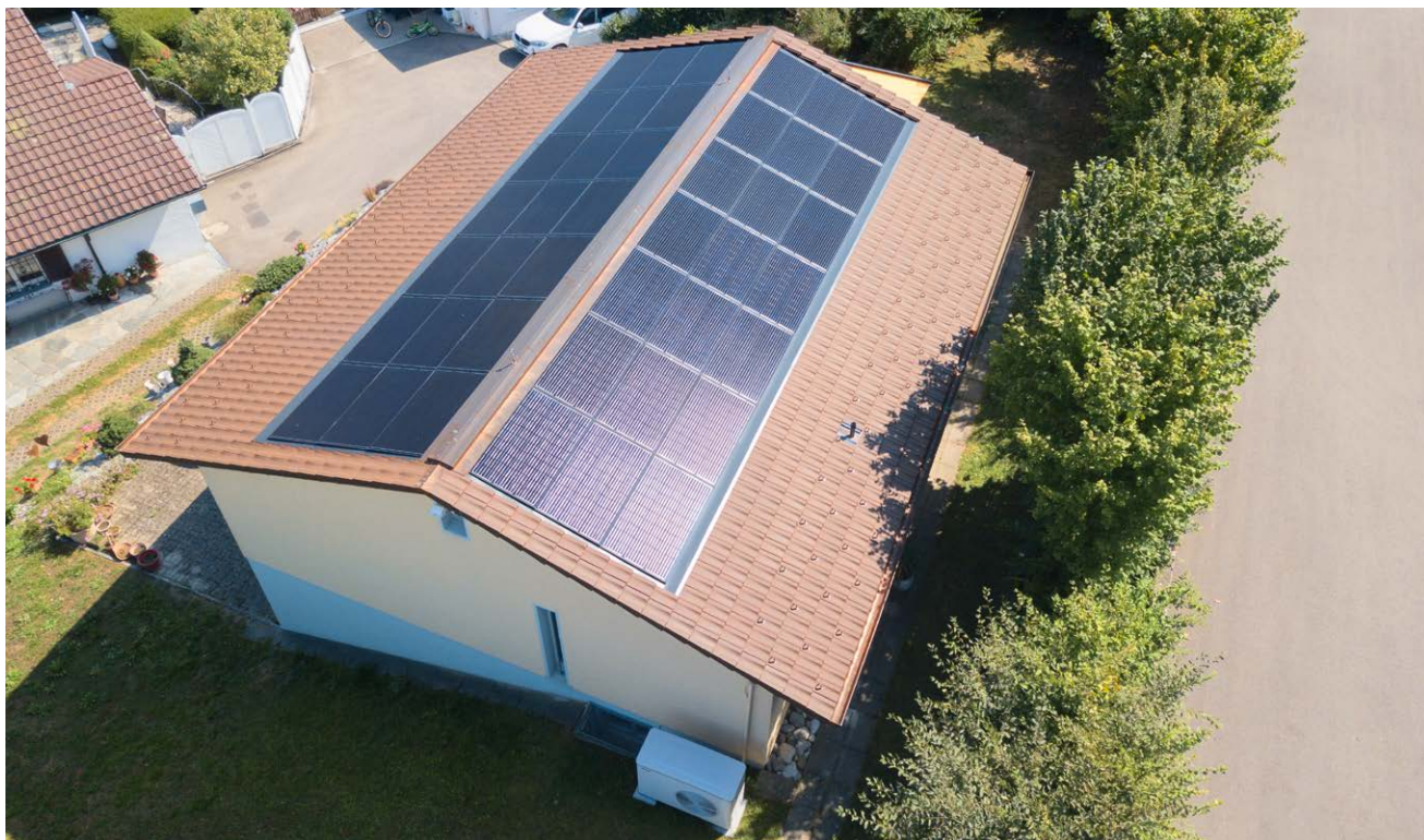
Zwei Komponenten des intelligenten Energiesystems: eine Indach-Solaranlage und eine Wärmepumpe in Bergdietikon.
