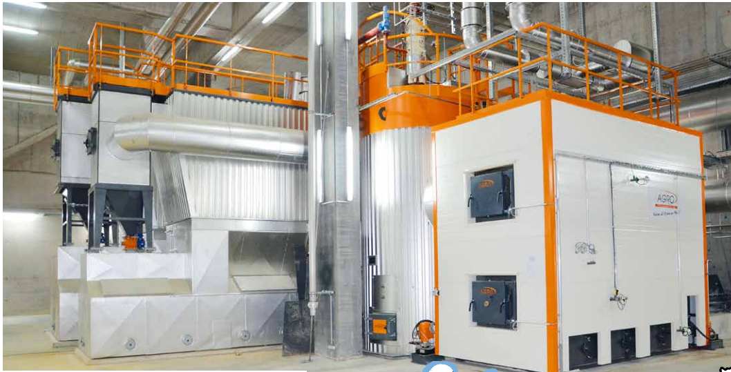
Wärmezentrale des Wärmeverbundes Bad Zurzach
