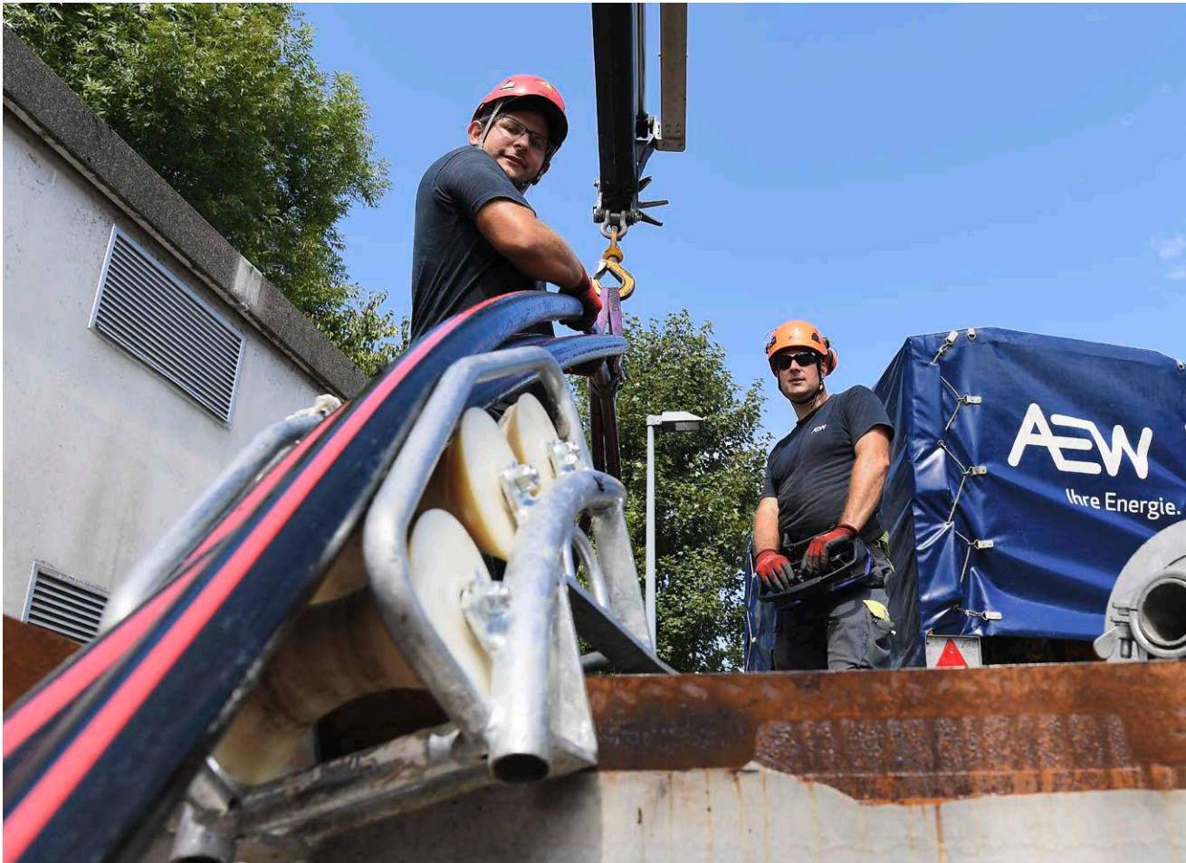
AEW Mitarbeitende sorgen für eine zuverlässige Stromversorgung in der Region
