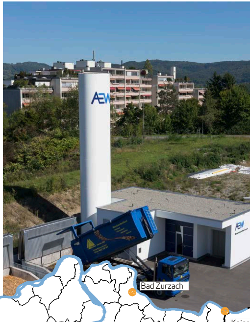
Wärmезentrale des Wärmeverbundes Bad Zurzach
