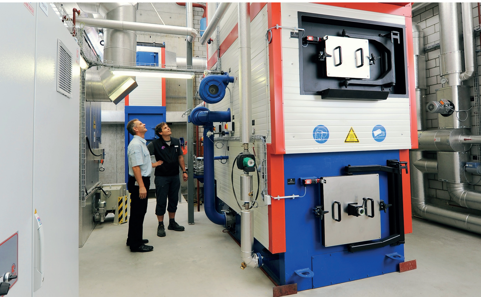
Das Herzstück der Anlage: der Heizkessel
