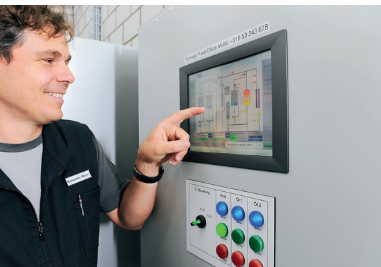
Eine ausgeklügelte Steuerung sorgt für die richtige Temperatur
