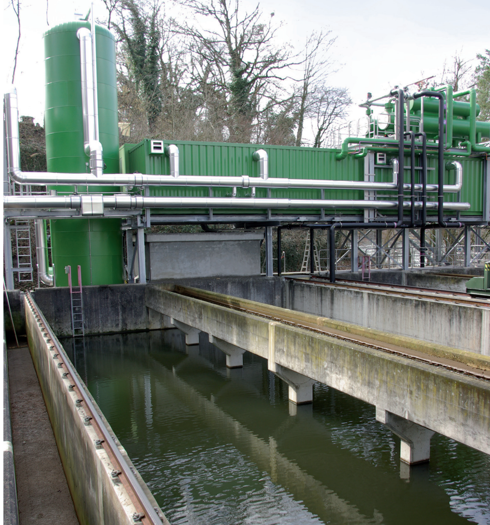
Wärmepumpencontainer in der ARA Rheinfelden
