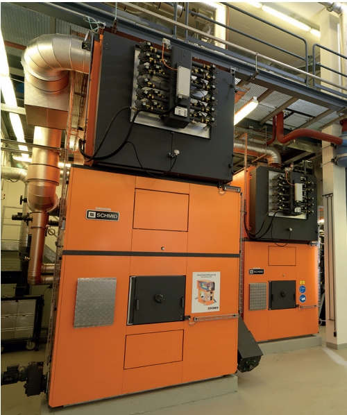
Der Heizraum in der Wärmehaus Isenlauf
